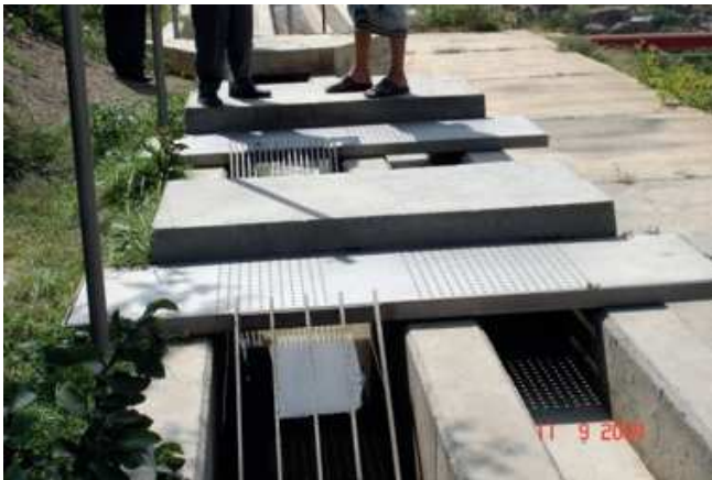
Figure 4: Dégrilleur à deux étages, d'abord à fort puis à faible écartement des barreaux à la station de la ville de Hajja, Yemen (source: El Hamouri, 2004).
