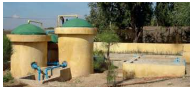
Figure 2: RAFADE en exploitation à Casablanca pour traiter les eaux usées d'une habitation privée (source: B. El Hamouri, 2004).
