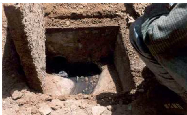
Figure 4: Réseau décanté à petit diamètre: regard de jonction de deux collecteurs village de Toug El Khir, Maroc (source: B. El Hamouri, 2002).
