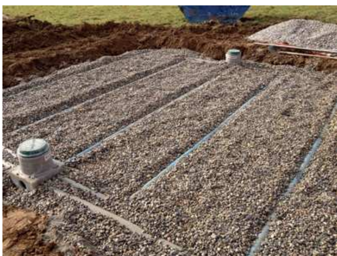
Figure 2: Filtre à graviers en France (source: CHARTEUSE TP).
