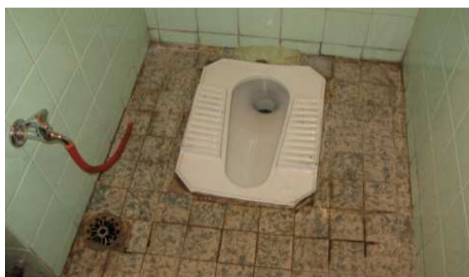
Figure 4: Cuvette à chasse mécanique dans une toilette desservant des bureaux à Damas, en Syrie. Noter le tuyau utilisé pour la lavage anal (source: E. von Muench, 2009).
