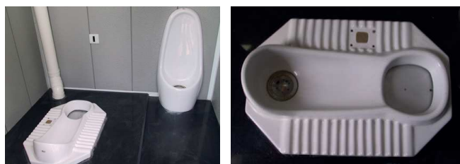
Figure 8: Exemple de toilette à séparation en Chine. (à gauche). La photo en à droite montre une cuvette à séparation d'urine avec un dispositif automatique pour ouvrir une trappe (voir flèches) vers la chambre de déshydratation (source: Werner, GIZ, 2007).
