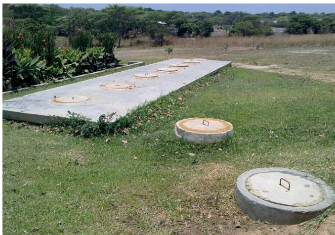
Figure 4: Système RAC raccordé aux toilettes d'une école péri-urbaine en Lusaka, Zambie. Le RAC (en avant plan) est précédé d'un digesteur. Il est suivi par la suite d'un filtre planté (à gauche) (source: R. Ingle, 2010).
