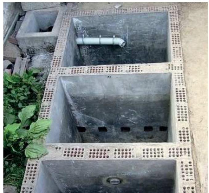
Figure 2: Vue de dessus d'une fosse septique à plusieurs compartiments, avant placement des dalles supérieures (source: Tilley et al., 2008).
