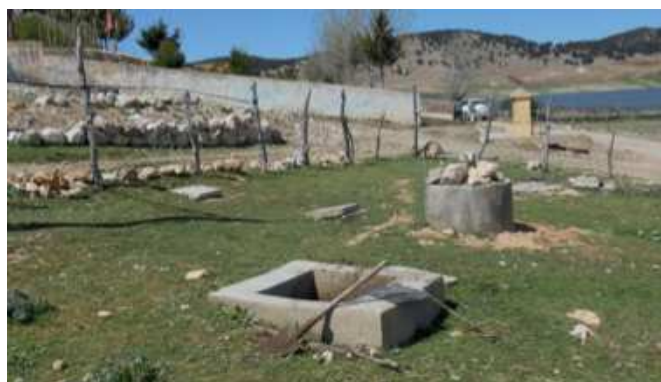
Figure 3: Digesteur classique à Dayet Ifrah, Maroc. A l'avant-plan: bac d'alimentation des eaux usées et fumiers; au centre: sommet du dôme du digesteur (source: M. Wauthélet, 2014).
