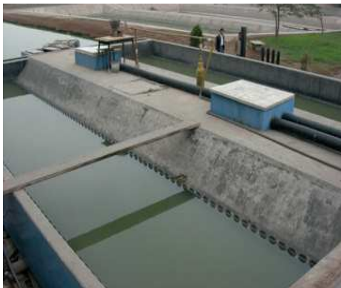
Figure 5: Vue en plan de l'UASB de la figure 4 montrant la surface de l'ouvrage avec au centre le séparateur de phase et la collecte du biogaz ainsi que les déversoirs d'évacuation de l'effluent situés de part et d'autre en longueur. Arrière plan: bassins de post-traitement (source: LeAF, 2010).
