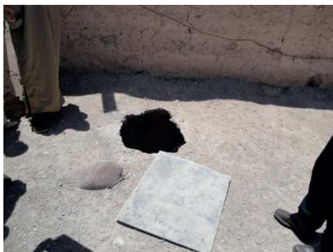
Figure 7: Effondrement d'une fosse de latrine traditionnelle. La latrine est située à l'intérieur de l'habitation; alors que la fosse est creusée sous une piste publique à Douar Chouirij, Province d'Al Haouz, Maroc. La plaque métallique est pour éviter des risques de chute des passants(es) dans la fosse. La pierre est pour empêcher la plaque d'être déplacée (source: El Hamouri, 2013).
