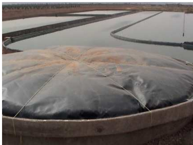
Figure 5: RAFADE d'El Attaouia début du projet Phase 1 (2003). Réacteur N°2 couvert à l'aide de PEHD: (polyéthylène à haute densité). En arrière plan: le chenal algal et les deux bassins de maturation en série (source: B. El Hamouri, 2003).
