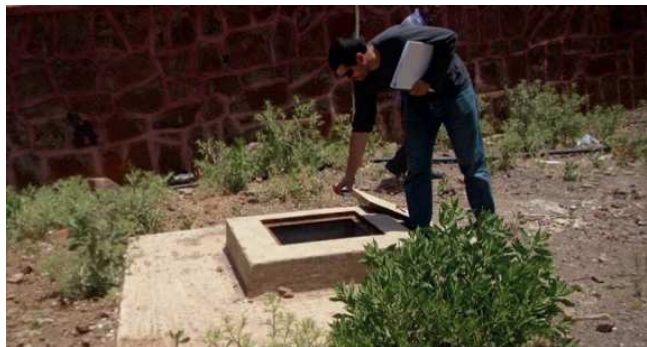
Figure 5: Fosse septique dans une école au Sud de Marrakech, Maroc (source: M. Wauthélet, 2012).
