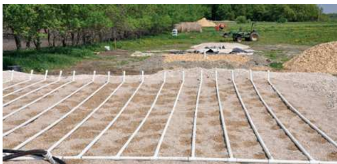
Figure 4: Filtre à sable à Gordon Orchard Farm au Canada (source: Agassiz Enviro-Systems Inc.).
