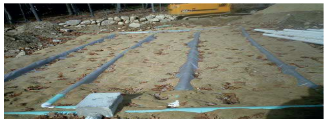
Figure 3: Exemple de lit d'infiltration garni de sable aux USA (source: NuMark Excavation & Land Clearing Inc.).
