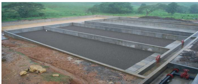
Figure 2: Lits de séchage dans le « Centre d'écologie et de gestion des déchets » à Bayawan, Philippines (source: J. Boorsma, 2009).
