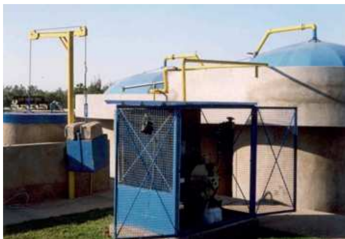
Figure 4: RAFADE de l'Institut Agronomique et Vétérinaire Hassan I, Rabat (IAV) avec unité de valorisation du biogaz (source: B. El Hamouri, 2003).
