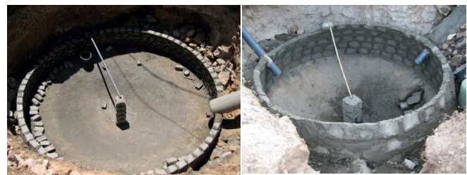
Figure 2: Construction de digesteurs pour une ferme, école et mosquée à Dayet Ifrah, Maroc (source: GIZ-AGIRE, 2011).
