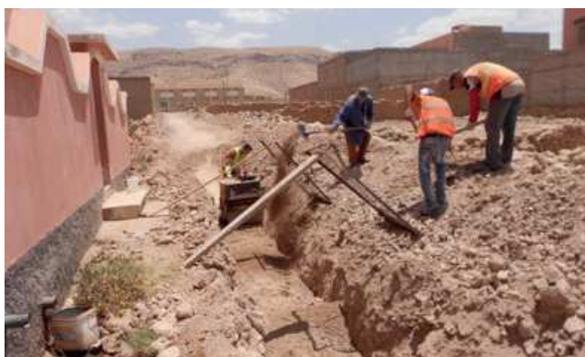
Figure 5: Travaux de pose, de remblayage, et de compactage d'un réseau d'égout conventionnel à la Commune rurale de Douirane, Maroc (source: DRPE , 2013).
