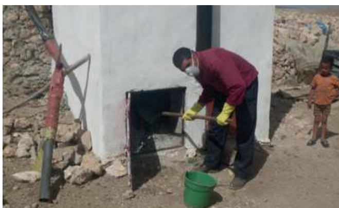
Figure 3: Evacuation manuelle de la chambre de déshydratation d'une TDSU à Dayet Ifrah, Maroc (source: GIZ-AGIRE, 2012).
