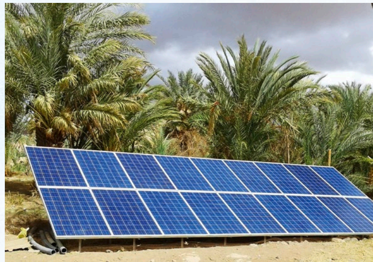
Photo 1 Installation photovoltaïque pour l'irrigation du palmier à Tata
