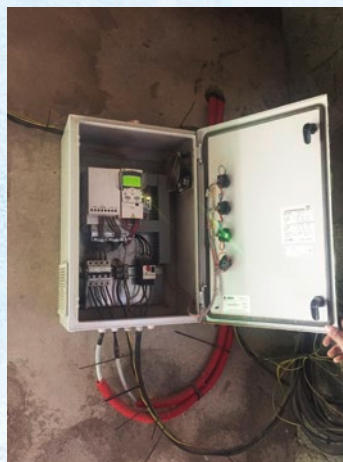
Photo 14 Unité de contrôle du système
