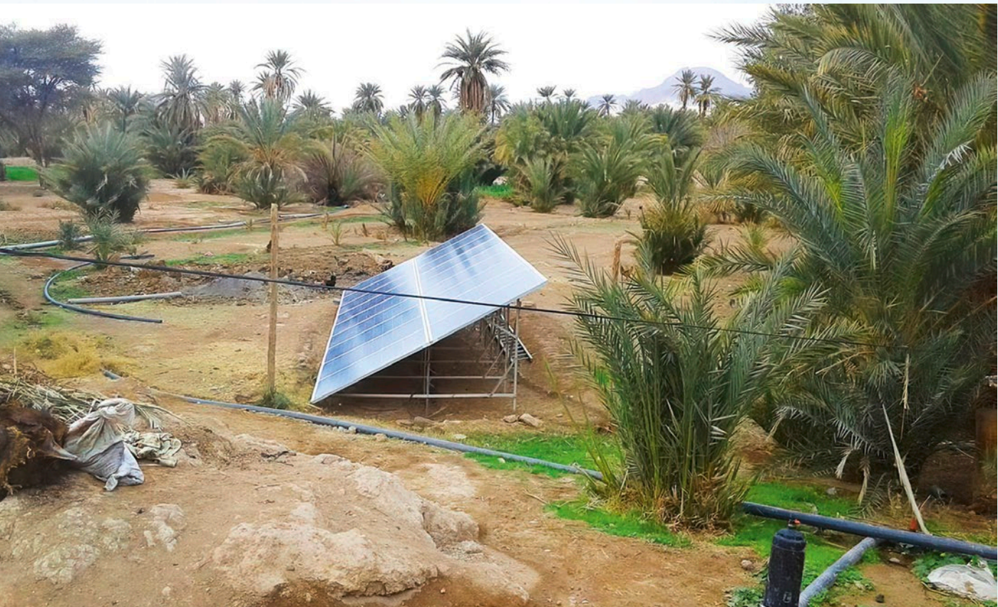
Photo 6 Installation photovoltaïque en palmeraie traditionnelle - Tata
