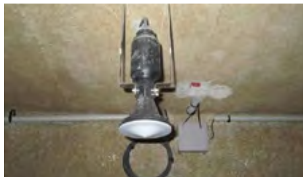
Figure 11 : Sonde de mesure à l'intérieur d'un déversoir d'orage situé rue Jean Berry à Givors (Source : SYSEG, 2012)
