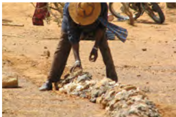
Figure 5 : Disposition des pierres après creusement de la tranchée le long des courbes de niveau (Source : CILSS)
