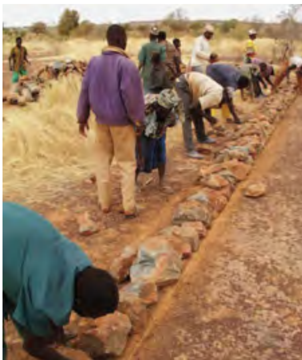
Figure 7 : Réalisation de Cordon pierreux dans le cadre du programme PATECORE, Burkina Faso (Photo: M. Landolt)
