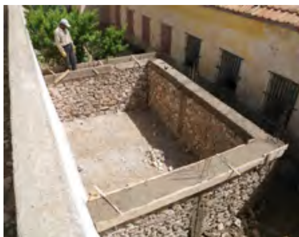
Figure 5 : Réservoir de captage d'eau pluviale de l'école primaire de Dayet Ifrah en construction (Source : GIZ/AGIRE)
