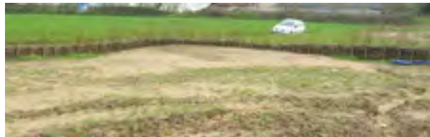
Figure 9 : Accumulation de sédiments en amont d'une fascine, France (Source : AREAS, 2012)
