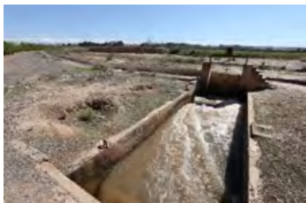
Figure 2 : Départ d'une séguia à partir d'un bassin, régulé par une vanne manuelle (Source : GIZ/AGIRE)
