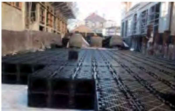
Figure 5 : Bassin de stockage pour régulation sous voirie avant rejet dans le réseau pluvial, Commune d'Arcachon, France (Source : Syndicat Intercommunal du Bassin d'Arcachon, 2012)
