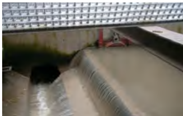
Figure 1 : Déversoir d'orage (Source : https://eau.public.lu/eaux_usees_pluviales/assainissement/deversoir_orage/index.html )
