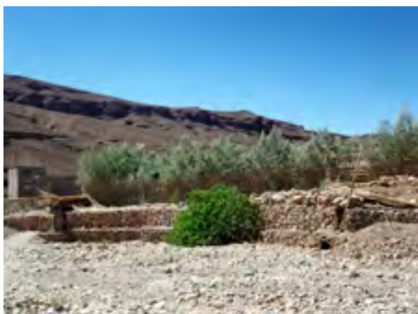
Figure 5 : Mur de soutènement en gabions protégeant les exploitations agricoles et constructions en amont, Ait Idir, Maroc (Source : GIZ/AGIRE)
