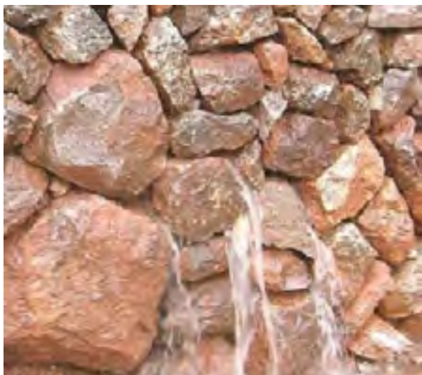
Figure 3 : Ecoulement des eaux de ruissellement à travers un mur en pierres sèches (Source : Alava et al., 2009)
