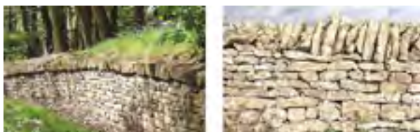
Figure 4 : Couronnement à plat à gauche et en clavade à droite (Source : Alava et al., 2009)
