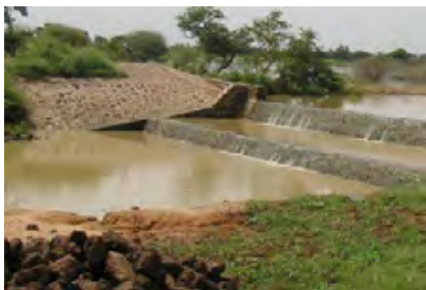
Figure 7 : Seuil d'épandage des eaux de crues à Kalfou dans la région de Tahoua, Niger (Source : Nill, 2012)
