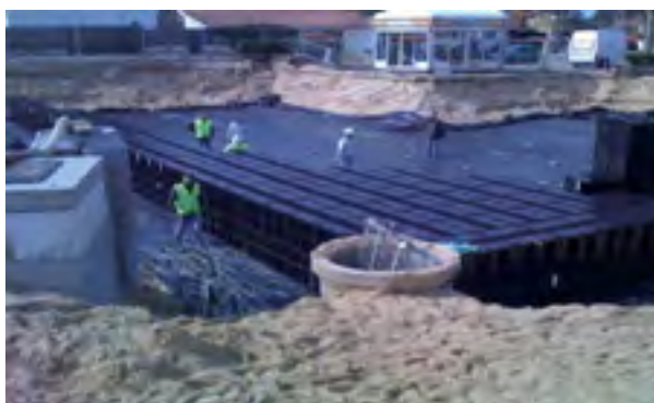
Figure 6 : Suppression d'un rejet d'eaux pluviales vers le milieu récepteur, Commune de Lège-Cap Ferret, France (Source : Syndicat Intercommunal du Bassin d'Arcachon, 2012)
