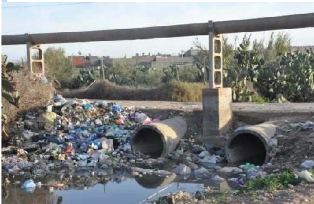
Rejet + l'air libre/ Dr Zemrane Périphérie MarraJech
