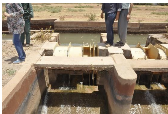
Photo 4 : Prise d'eau équipée par des modules à masque à l'amont du Giraudet Old Maazouz sur le canal Ouest. Source: ATH-RESING, 2014
