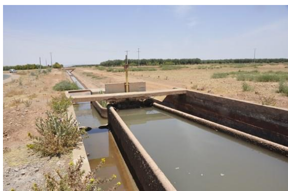
Photo 3 : Giraudet du partiteur Ouled Maazouz sur le canal Ouest. Source: ATH-RESING, 2014
