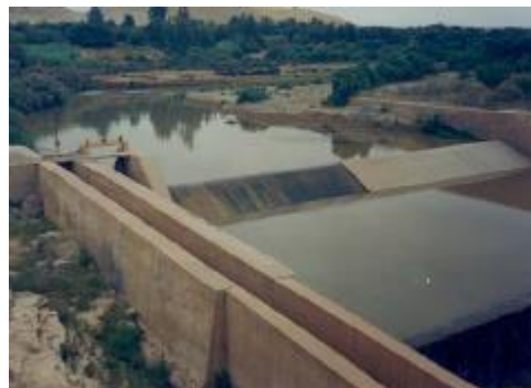
Photo 11 : Point de dérivation de la seguia Rguiguia, Source : ABHT
