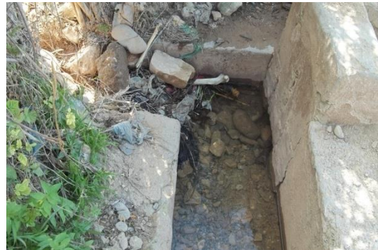
Obstruction de la brèche à l'aide de pierres et chiffons au lieu de vannes glissantes
