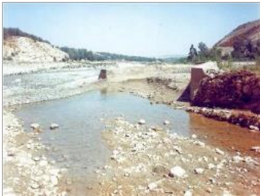
Photo 3 : Dérivation de la seguia Tafechtalt sur la rive droite de l'oued Assif Al Mal. Source : ABHT.
